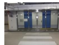
エレベーター
